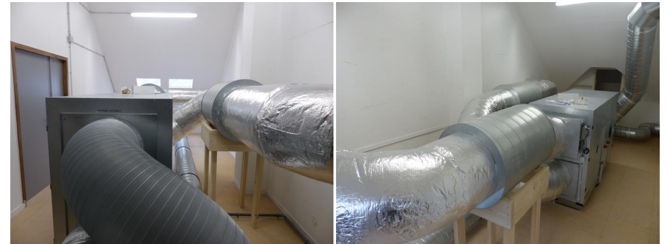
Le système de ventilation impressionnant de la salle polyvalente
